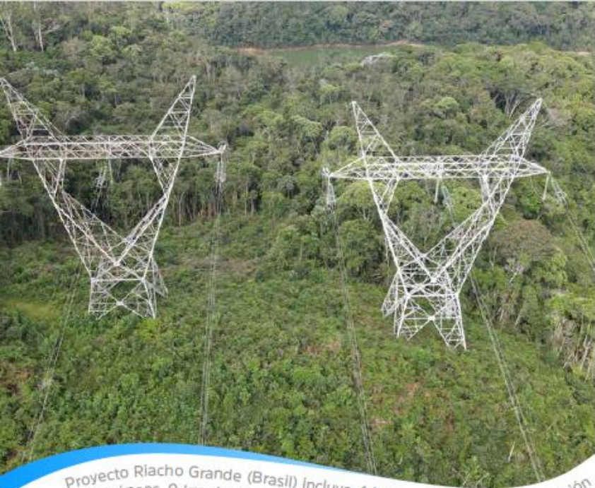
Proyecto Riacho Grande (Brasil) incluye 44,6 km de líneas de transmisión subterráneas, 9 km de líneas de transmisión aéreas y tres subestaciones.
